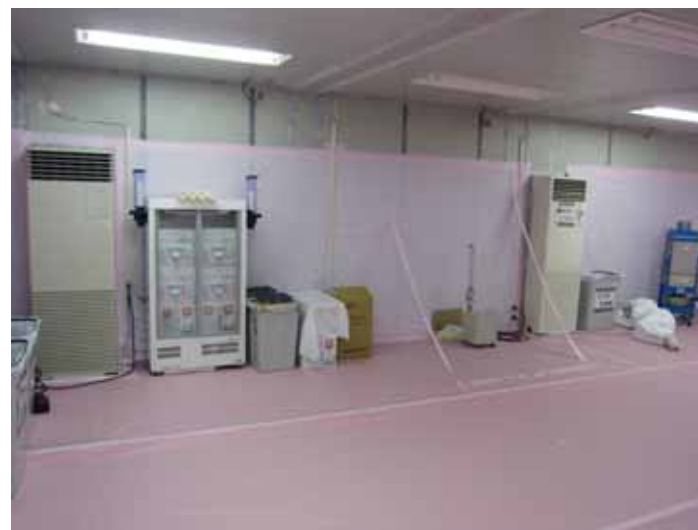
撮影日 : 平成23年5月19日 13時頃 場所 : 休憩所内設備（左から2番目は飲料水、右端は局所排風機、 右エアコン左はダストサンプラ 撮影 : 東京電力株式会社
