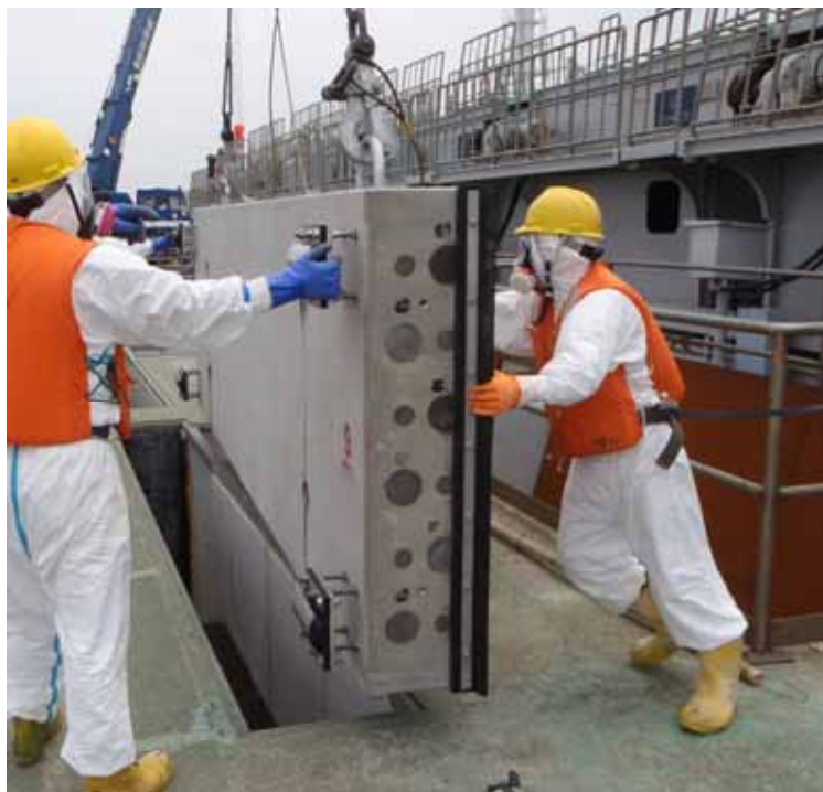
撮影日：平成23年 6月12日 場 所：2号機取水口上部 撮 影：東京電力
