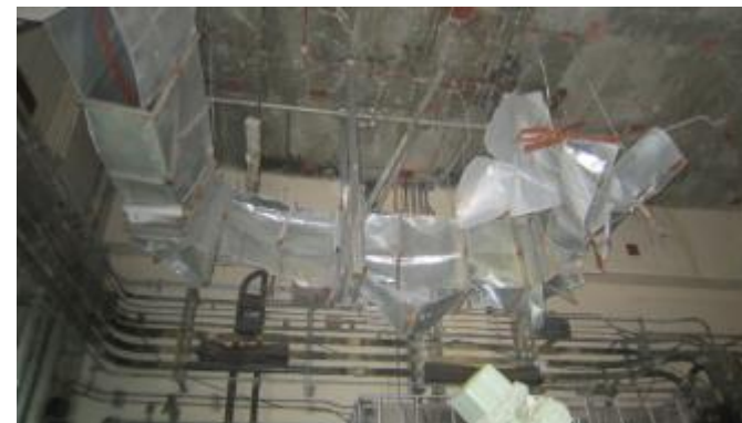
③ 換気ダクトの変形
