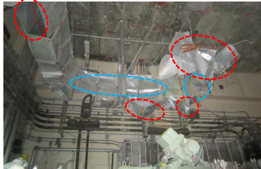
② 換気ダクトの変形
