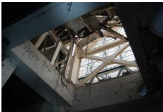
① 機器ハッチ蓋の消失
