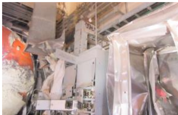
② MCC/仮設トイレの変形
