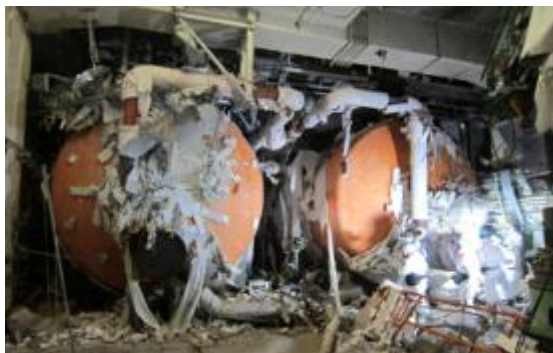
④ ICタンク南側の保温材の剥がれ
