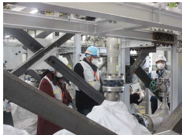
ALPS 処理水の移送設備を視察
