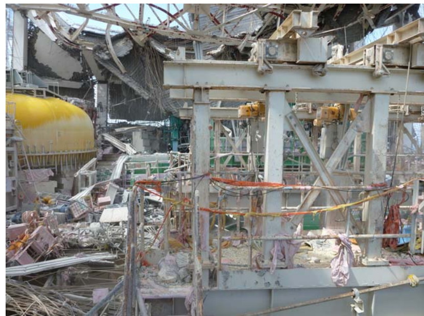
燃料交換台車より機器貯蔵プール側
