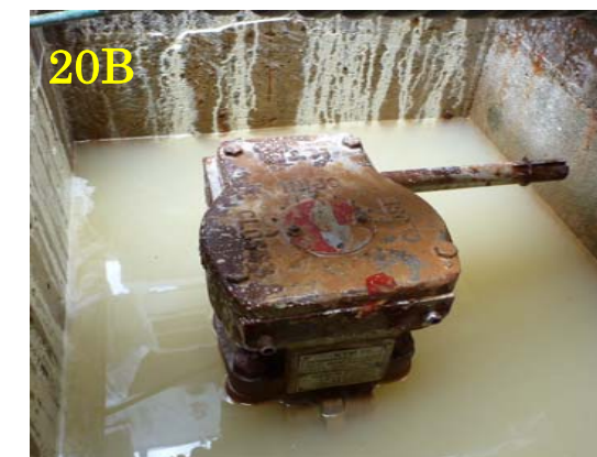
燃料プール冷却浄化系バルブ
